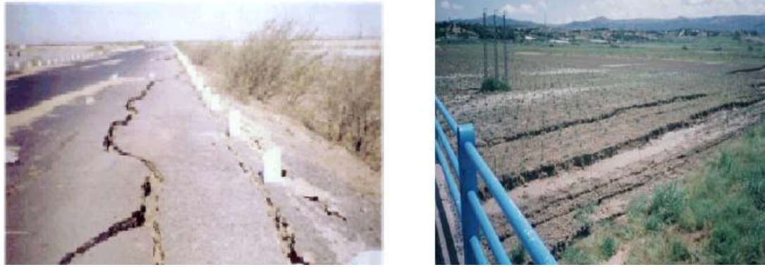
Figure 8 déplacements latéraux du terrain
