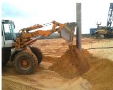
Figure 8 Remplissage de l'affaissement conique par un matériau d'apport (Barrage -Harka- TUNISIE).
