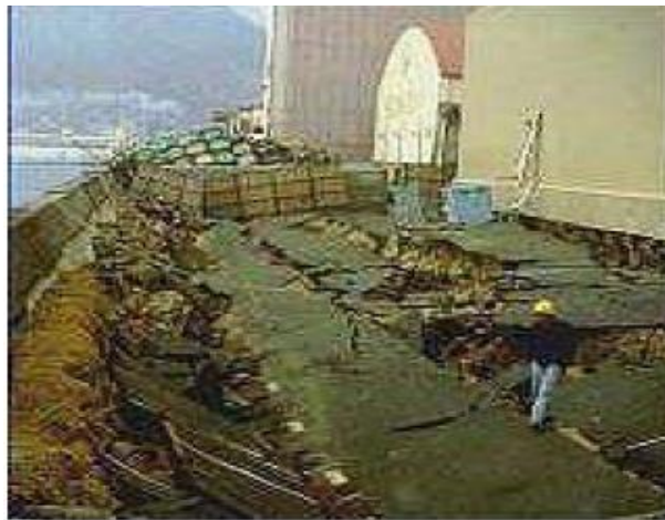
Figure 3 Inclinaison des murs de soutènement
